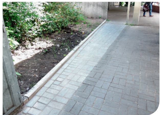
Bild 5: S-Bahn-Haltestelle Neugraben, Wartebereich Bushaltestelle nach Einwirken der HUK
